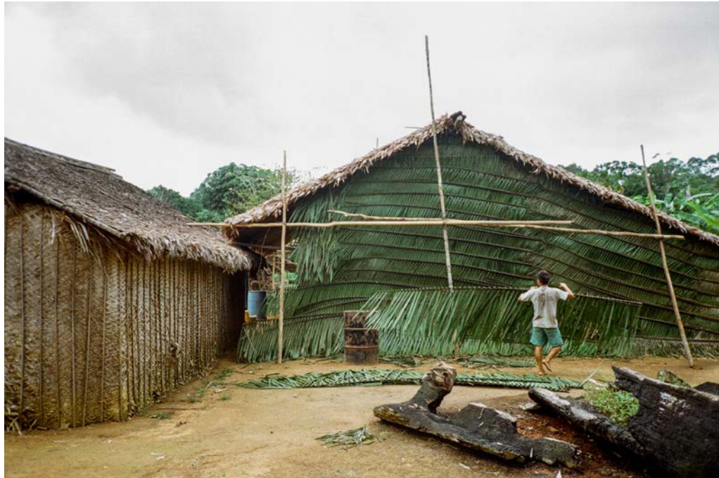
Fig. 42-44. Casa tipo “ecológica” de Moisés, o segundo përiomi do xapono Pukima Cachoeira. Acima, na página anterior, vista dos fundos e em obras, conduzida pelos seus genros. E abaixo, detalhe do encontro da viga transversal dos fundos ( pariparima ) com o pilar ( totahima ), amarrado com nó de cipó em “X” ( okaoyakiraorewë ) e caibros ( hõrõhõrõma ) amarrados sobre a viga com cipós passando sobre e ao redor destes, na área da casa conhecida por “os fundos da casa” ou “o baixo da casa” ( hato nahi xîka ). Nessa página, acima, Emerson, um dos genros, trabalhando e me ensinando a fechar as casas com palhas de curuá ( yawatoa ), sobrepostas e amarradas com cipó. A estrutura de andaimes é para alcançar as partes mais altas da casa e, à frente, praticamente encostando na casa em obras, esta a antiga e pequena casa de Moisés, construída preliminarmente quando estes se mudaram para este novo xapono em 2014. Com a conclusão da obra, aumentando o diâmetro do xapono , a antiga casa irá se tornar lenha, conforme me explicava Emerson (2019).
